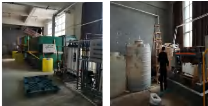
图 3-6 废水处理设施
