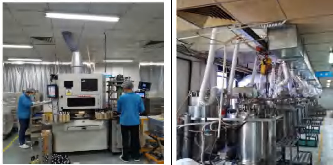
图3-1 废气车间收集管道
