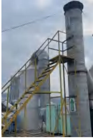
图3-3 废气处理设施
