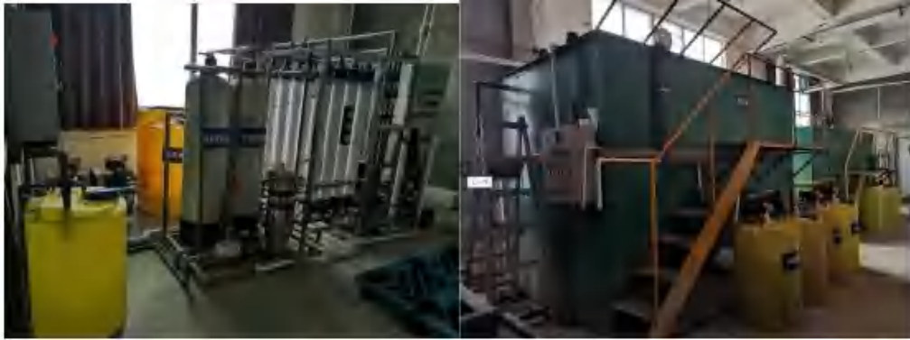
图 3-5 废水处理设施
