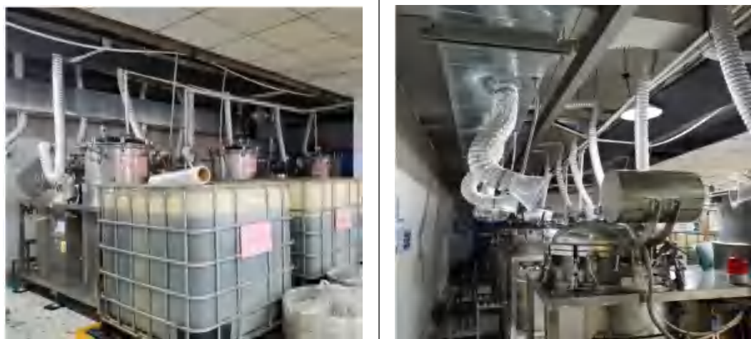
图3-2 废气车间收集管道
